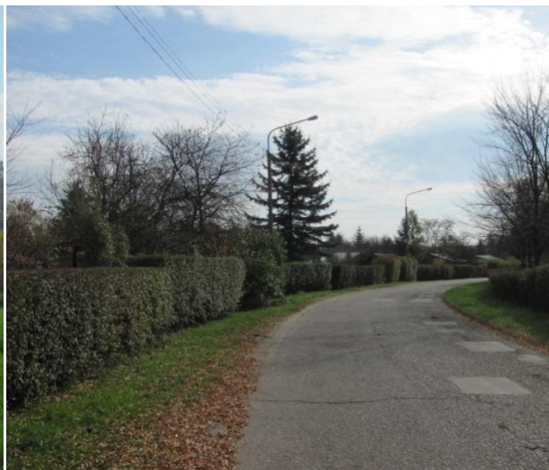
Zdjęcie 2. Przykład zdegradowanej nawierzchni ulicy wewnątrz obszaru.
